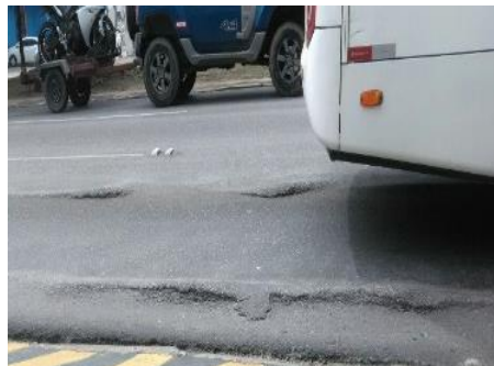
Figura 1: Deterioração da via: ondulações.
